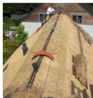
Het leidingsysteem zoals dat onder iedere nok wordt aangelegd.
